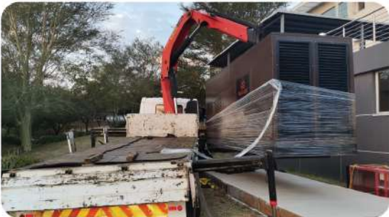
Mowana Properties - 500kVA
